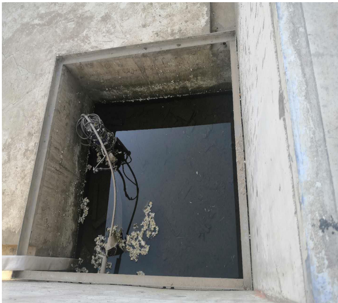
图 4-5 集液池现场照片
