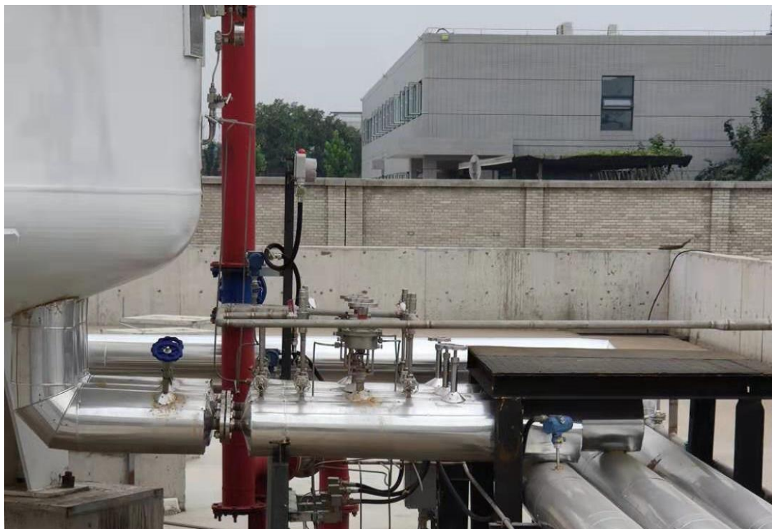
图 4-1 LNG 储罐手动截止阀现场照片
